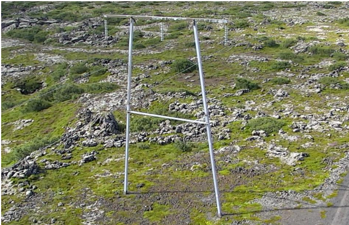
Mynd 3.1 Stálmastur í Suðurnesjalínu 1.
